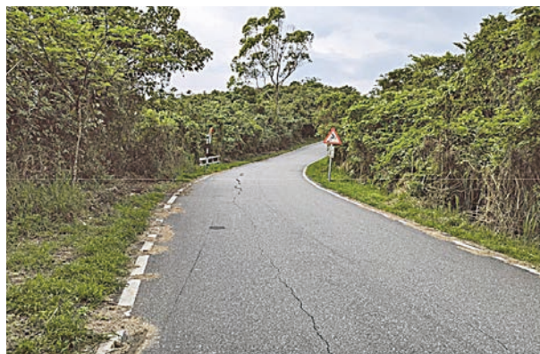
圖 99 0423 東山安樂園鄰近柏油路面裂縫
