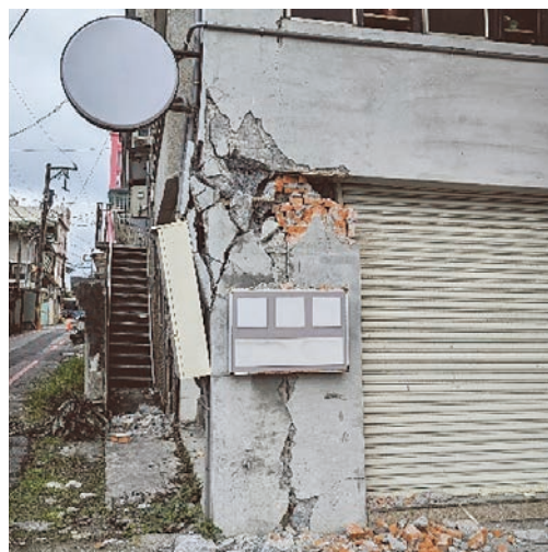
圖 26 北濱街 6 號民宅夾層柱剪力破壞
