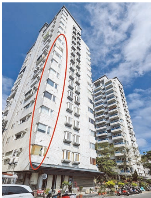
圖 51 蓮花大樓窗台牆斜向裂縫達 11F (西側)
