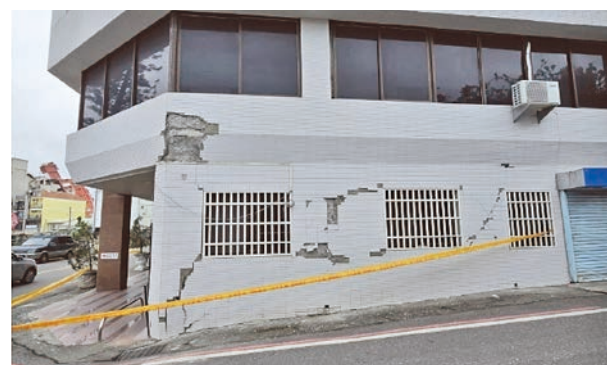
圖 36 更生日報底層牆面窗斜向裂縫
