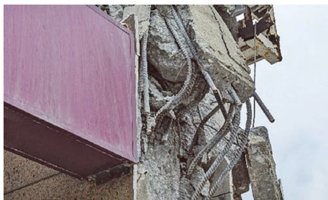
圖 23 統帥花蓮大樓損壞嚴重
