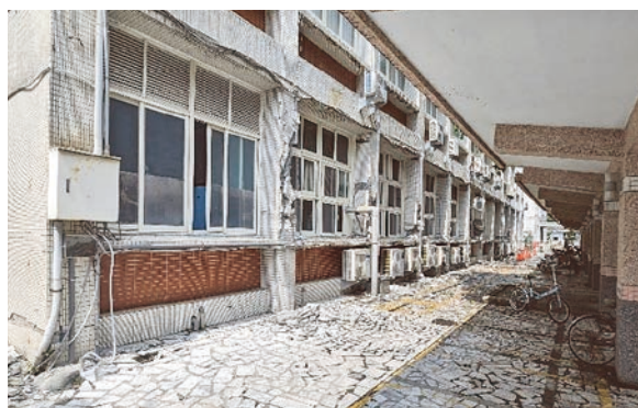
花蓮女中綜合大樓震後東側外觀
