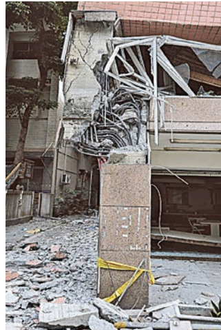
圖 104 0423 統帥花蓮大樓夾層粉碎
