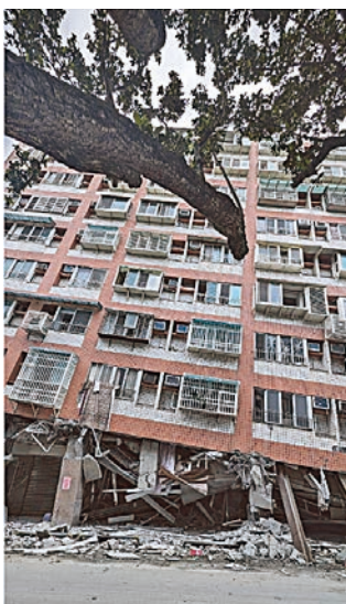
圖 106 統帥花蓮大樓 1F 騎樓柱嚴重破壞
