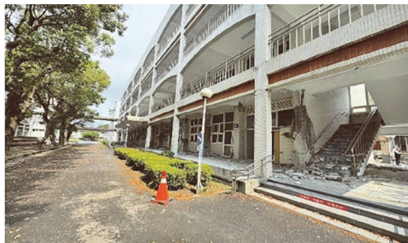
花蓮女中綜合大樓震後南側外觀
