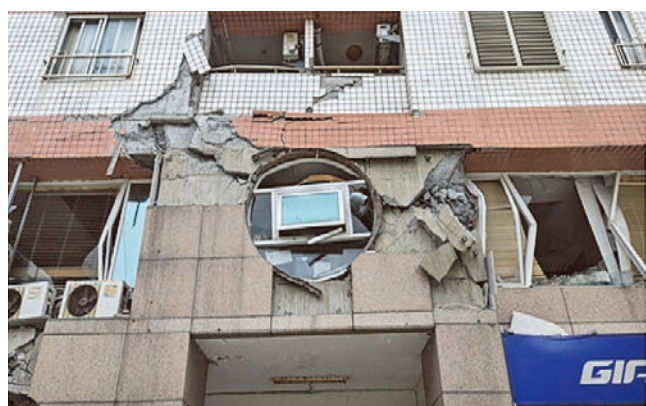
圖 22 統帥花蓮大樓夾層柱破壞
