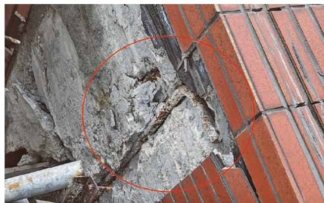
圖 11 天王星大樓標準彎鉤不當設置（北側拍攝）
