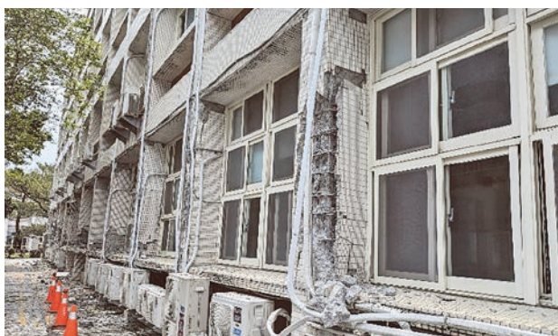
花蓮女中綜合大樓震後北側外觀
