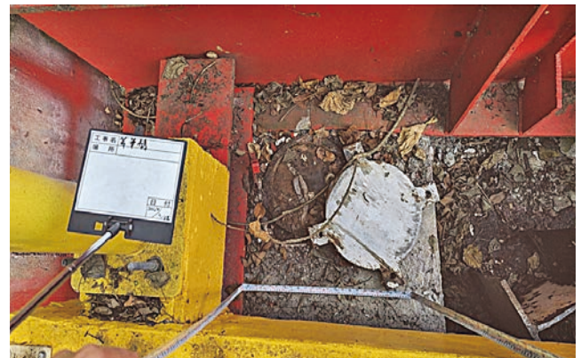
圖 94 菁華橋北側支承錯動脫落
