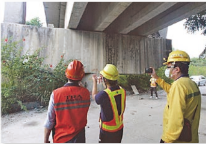
2022 年 918 地震造成臺鐵新秀姑巒溪橋 主梁錯位損壞
