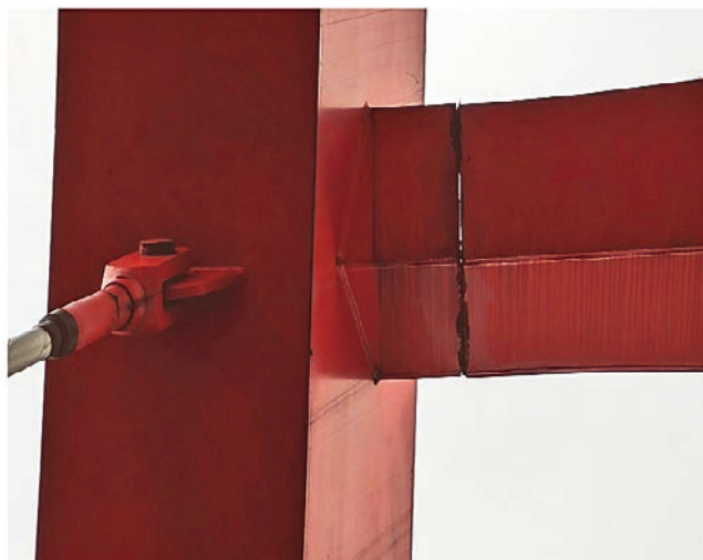
圖 77 美崙溪橋西南側梁構件鉚道斷裂（見光）
