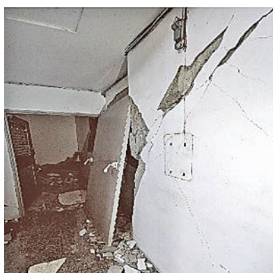
圖 24 統帥花蓮大樓梯間牆破壞
