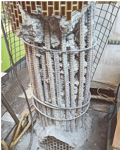
圖 65 鋼管紅茶店柱端部核心混凝土破壞（柱底部部搭接）
