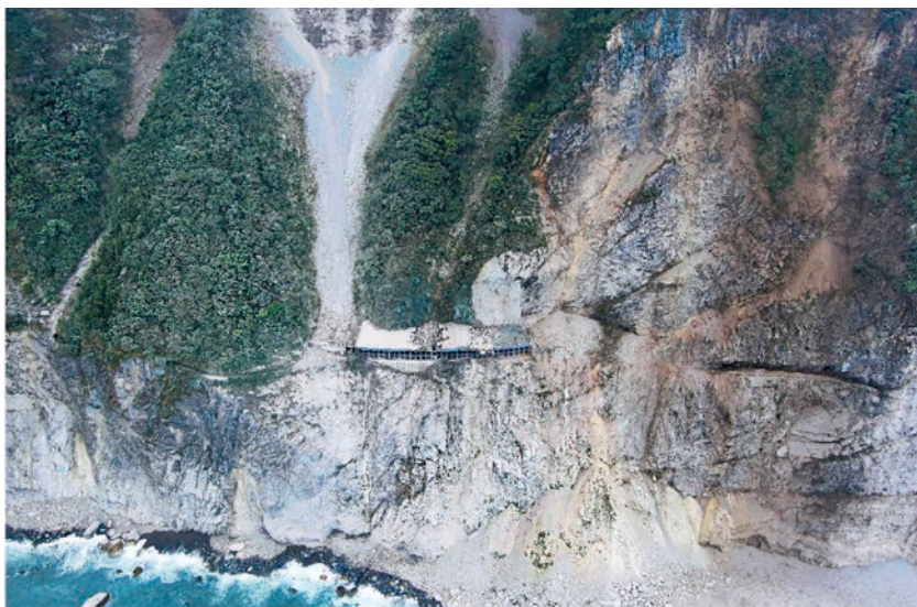
圖 2 大清水明隧道無人機空拍影像：隧道頂部遭落石砸破部分坍塌
