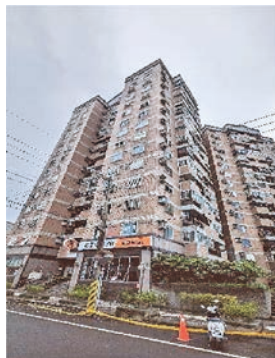
山海觀大樓震後西北側外觀
