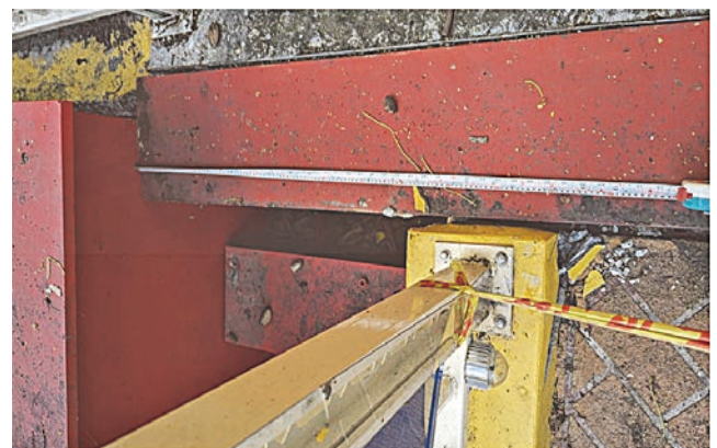
圖 93 菁華橋北側橋端東西向錯位約 86 cm
