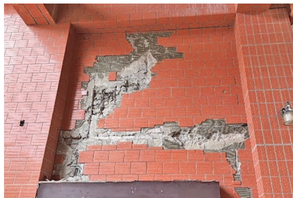
圖 44 靛邑京華梯間牆 X 型 + 水平裂縫
