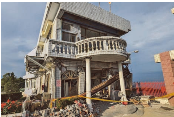
圖 97 0423 東山安樂園震損建物外觀
