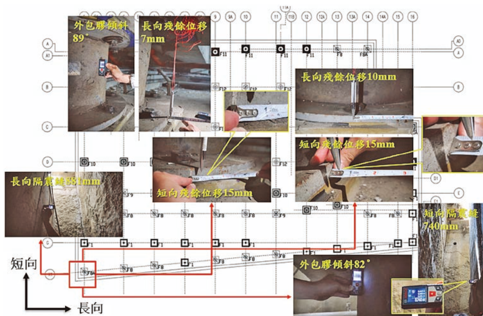
圖 12 花蓮慈濟醫學中心合心樓隔震系統勘查量測
