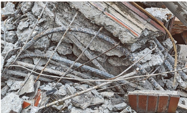
圖 14 天王星大樓柱主筋彎折、箍筋脫開（北側拍攝）
