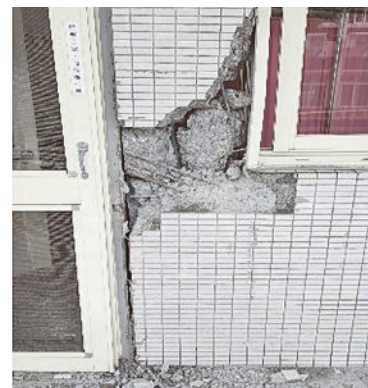
圖 68 花蓮女中窗台牆短柱破壞
