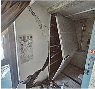
圖 86 0423 藍天麗池飯店牆體剪力破壞
