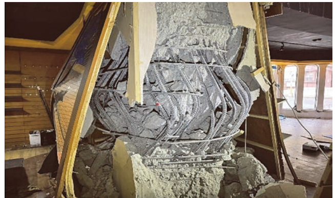
圖 18 統帥花蓮大樓柱爆裂主筋挫屈呈洋蔥狀
