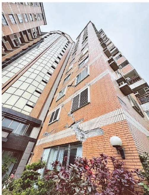
圖 49 山海觀大樓東側入口外牆受損至 6F
