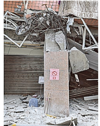
圖 109 統帥花蓮大樓 1F 騎樓柱嚴重破壞
