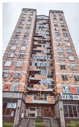
圖 47 山海觀大樓北側外牆受損至 9F
