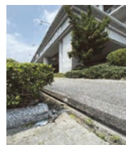
(a) 花園石墩受損
