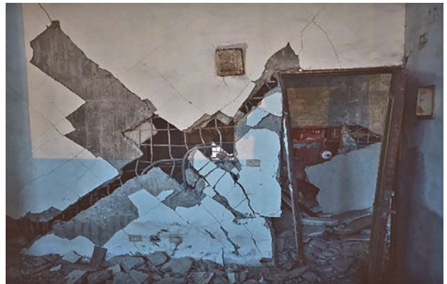
圖 61 華爾街大樓 3F RC 牆損壞嚴重
