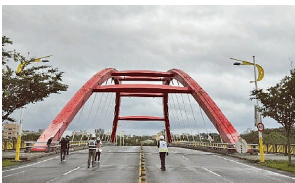
美崙溪橋震後西側外觀
