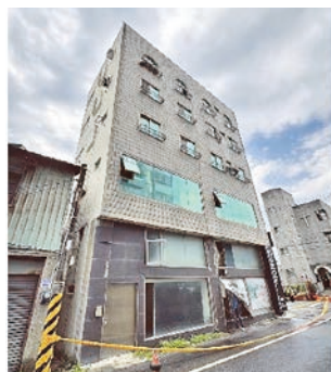
博愛街 52 號民宅震後東北側外觀
