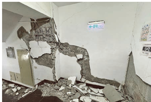
圖 41 靛邑京華梯間柱體嚴重剝落
