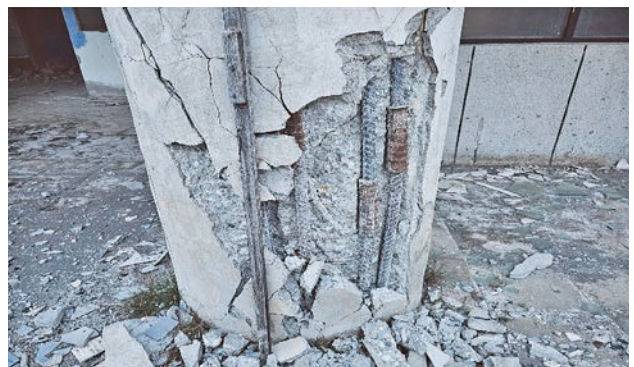
圖 63 華爾街大樓 3F 圓柱保護層厚度不足、箍筋間距過大且未箍於主筋外側
