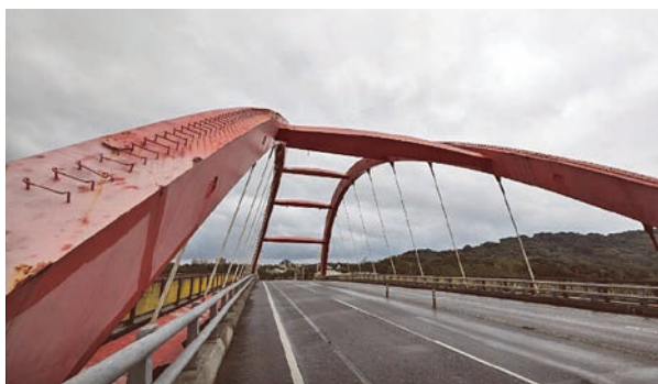
美崙溪橋震後西側外觀
