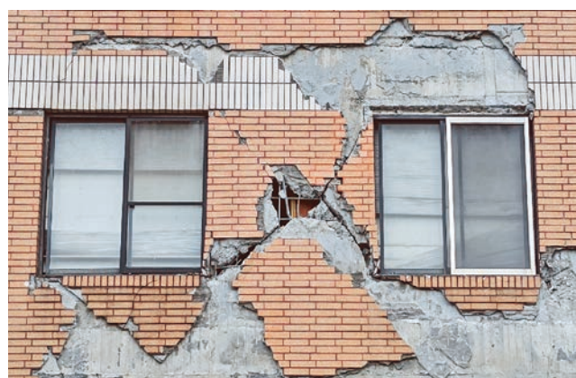
圖 46 山海觀大樓西南側窗間牆 X 型裂縫
