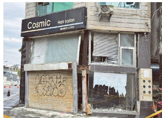
圖 34 博愛街 52 號民宅騎樓增建鋼柱傾斜
