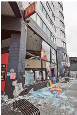
圖 29 吉安麥當勞大樓 損害外觀
