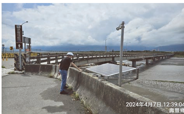
花蓮大橋震後東側外觀
