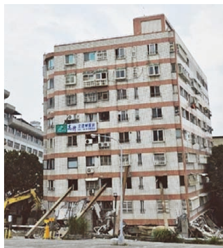
圖 101 0423 統帥花蓮西北側震後外觀 (攝影：林家宏)
