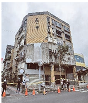
北濱街 6 號民宅震後北側外觀
