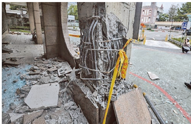
圖 21 統帥花蓮大樓轉角柱損壞嚴重
