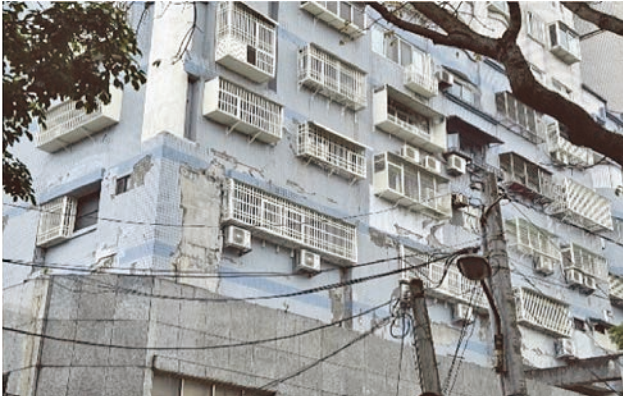
圖 56 華爾街大樓東北側外觀（損害牆體呈南北向）
