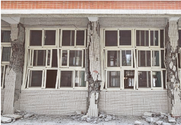
圖 69 花蓮女中窗台牆短柱破壞
