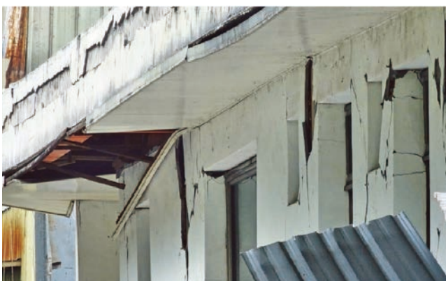
圖 90 0423 吉安鄉自強路廢棄工廠倒塌
