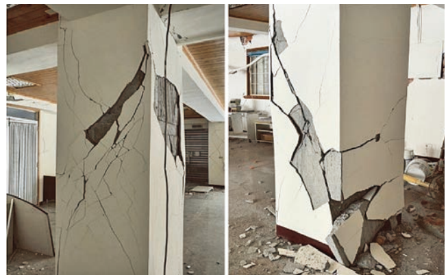
圖 19 統帥花蓮大樓柱體扭轉剪力破壞
