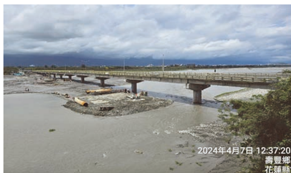
花蓮大橋震後南側外觀
