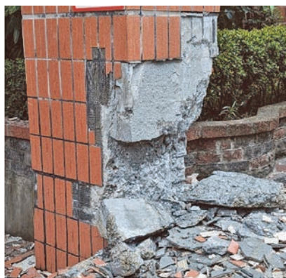
圖 39 靛邑京華柱損壞（保護層過厚之虞）
