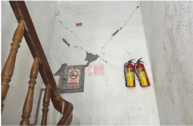
圖 28 北濱街 6 號梯間牆剪力破壞
