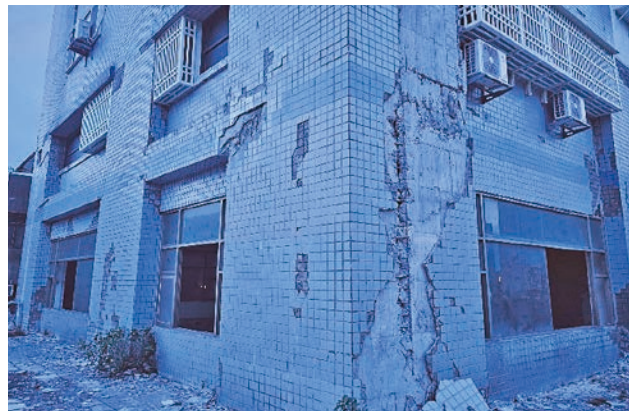
圖 62 華爾街大樓 3F RC 外牆損壞嚴重
