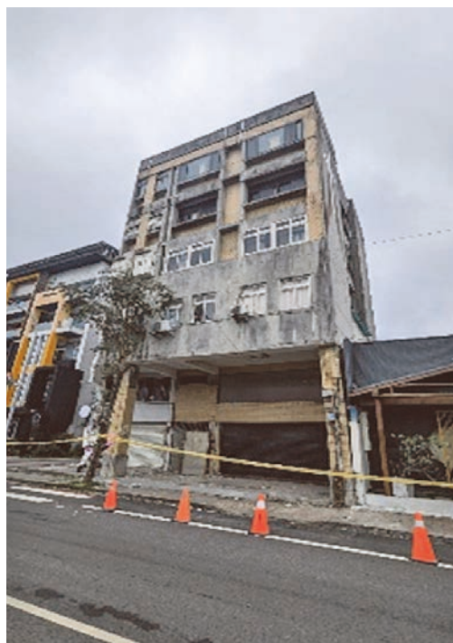
圖 27 北濱街 6 號民宅外觀已傾斜
