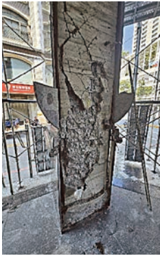
圖 85 0423 藍天麗池飯店柱體剪力破壞
