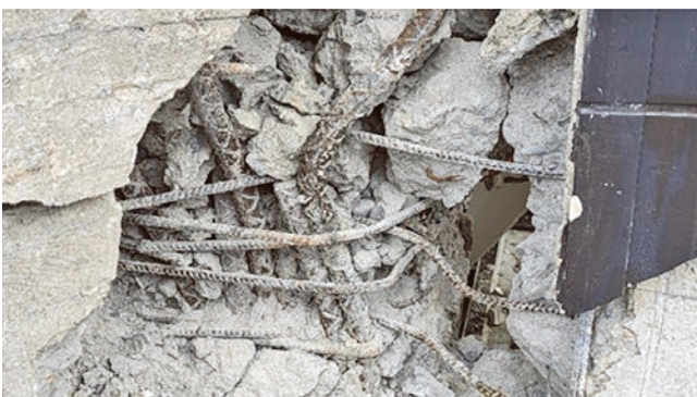
圖 32 吉安麥當勞柱核心混凝土碎裂
