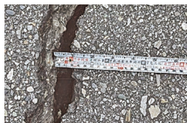
圖 100 東山安樂園鄰近柏油路面裂縫約 3 cm
