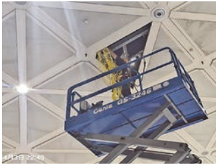
第二航廈1樓入境大廳挑高區天花掉落後先予以防護（掛墜網）
