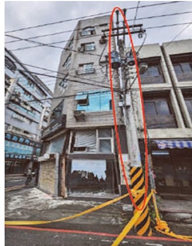
圖 33 博愛街 52 號民宅外觀已向北傾斜
