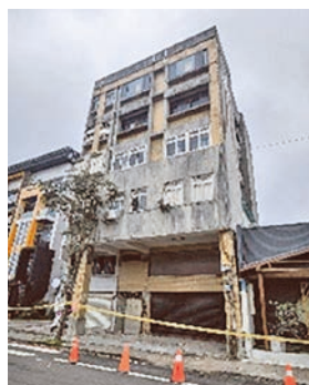
北濱街 6 號民宅震後西側外觀
