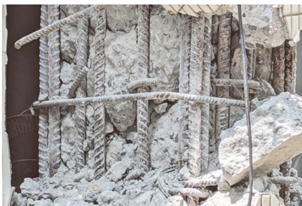
圖 70 花蓮女中柱箍筋脫開、彎鉤角度不足
