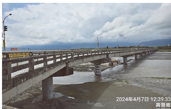
花蓮大橋震後東側外觀
