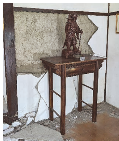
圖 75 慶修院壁體灰泥剝落
