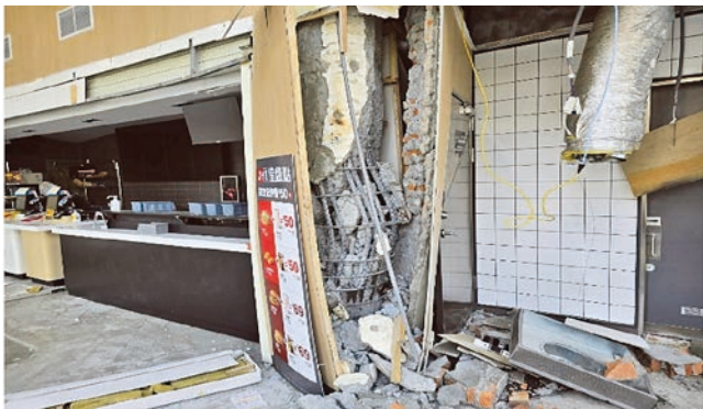
圖 31 吉安麥當勞柱嚴重損害、主筋挫屈
