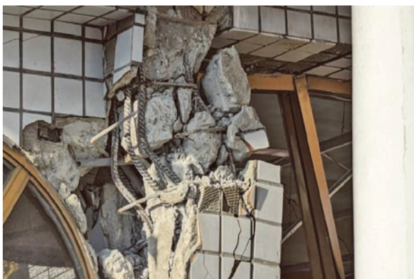
圖 98 0423 東山安樂園柱頂剪力破壞、主筋嚴重彎折
