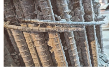
圖 66 鋼管紅茶店圓柱箍筋端部無彎鉤
