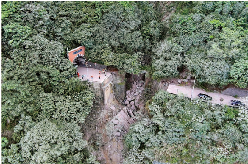
圖 1 大清水隧道口外之下清水橋無人機空拍影像：橋體遭大型岩塊砸斷
