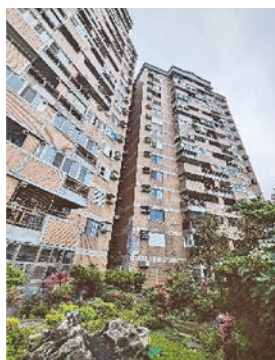
山海觀大樓震後西側外觀
