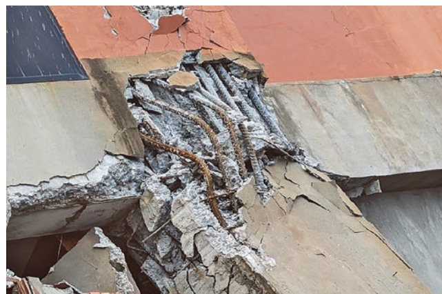
圖 12 天王星大樓接頭主筋挫屈、箍筋脫開（北側拍攝）
