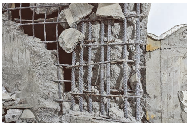
圖 40 靛邑京華柱核心混凝土碎裂、主筋變形
