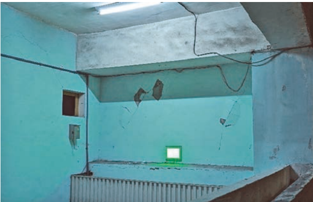
圖 57 華爾街大樓 RC 牆體水平裂縫（南北向）
